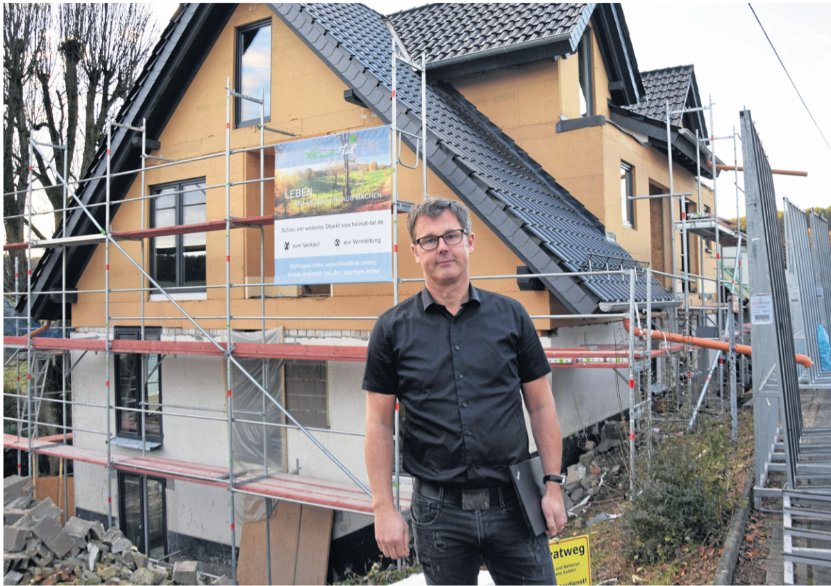
Eigentlich ist Prof. Dr. Christian B. Jung IT-Experte, doch aus der Wohnungsnot auf den Dörfern hat er eine Tugend gemacht, kauft alte Immobilien und baut sie zu attraktiven Mehrfamilienhäusern um. FOTO: JOSEF SCHMIDT
